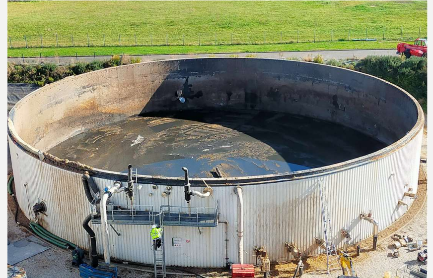
Post-digesteur ouvert et nettoyé
