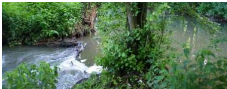
Effondrement seuil Jarcy mai 2009
