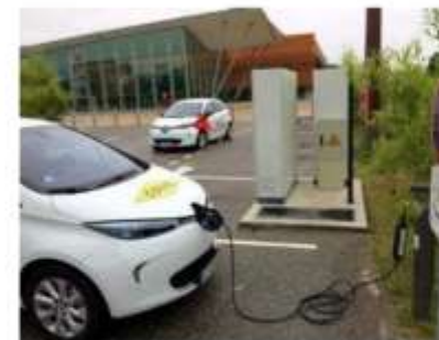
Installation pour la recharge de véhicule
