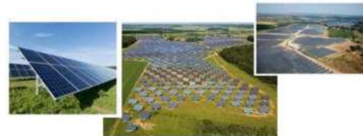
Exemples d'installation PV au sol
